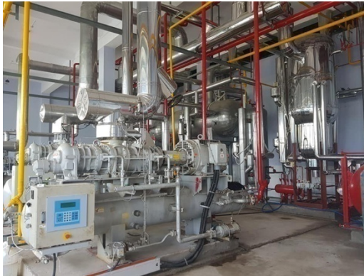
Hệ thống chiller, hệ thống lạnh nhà xưởng Chiller system
